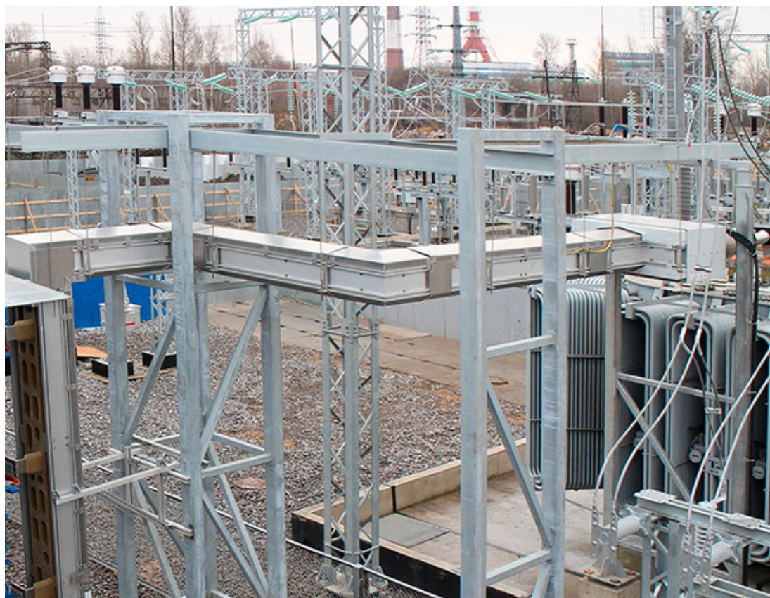
Подстанция «Красный октябрь» ПАО «Россети Ленэнерго». Токопроводы ТКЛС(А)-6-4000 УХЛ1 и ТПЛА-6-4000 УХЛ1
