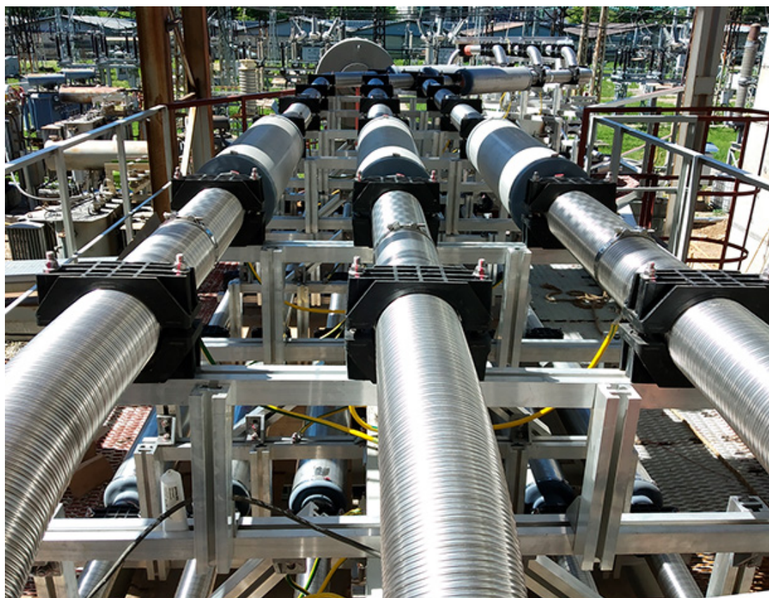
ТЭЦ-20 ПАО «Мосэнергo». Токопровод ТПЛА-6-2000 УХЛ1
